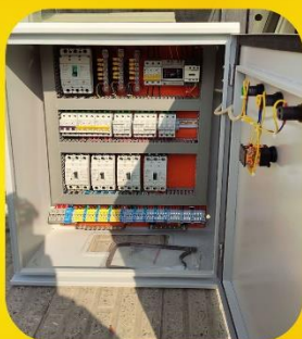
تابلو برق دیواری توزیع
